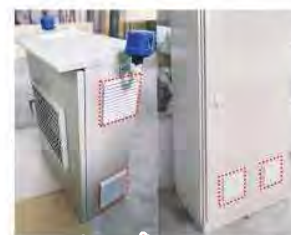
ตัวอย่างติดตั้งงานตู้คอนโทรล
