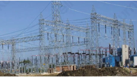
COLOMBIA : CENTRAL 20MW EPM-EPC SE MALENA SUBSTATION 230 KV
